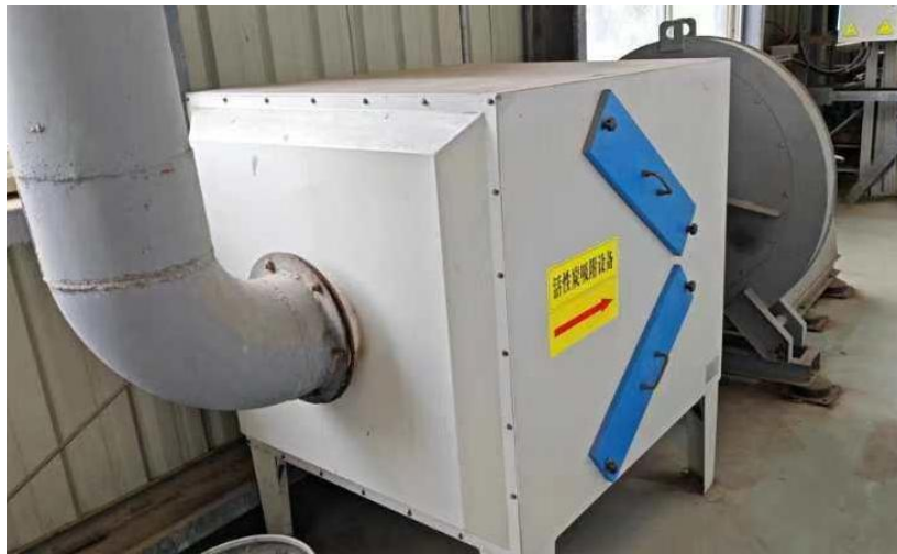
现有工程处理油雾的二级活性炭吸附装置
