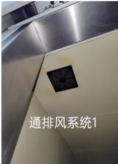
X 射线检测间通排风系统
