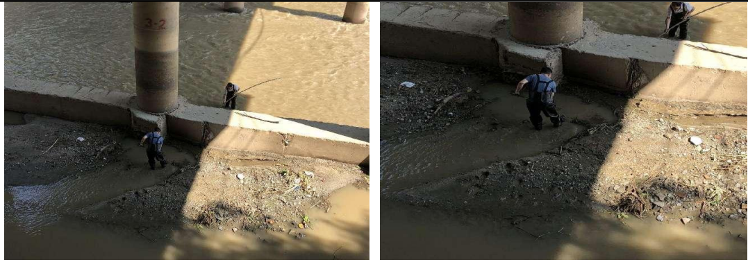
图 3-7 仁和沟桥河床下切，墩柱外露
