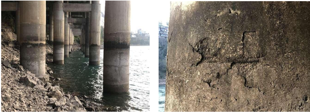
图 3-8 沿江大桥桥梁墩柱及基础病害现场照片
