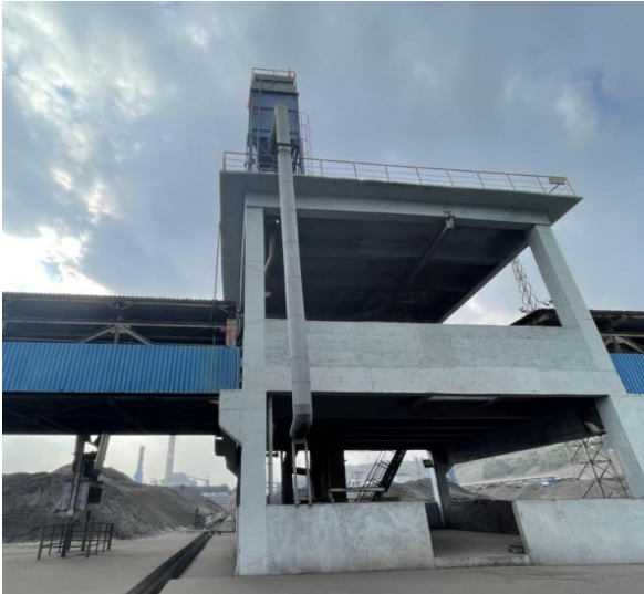
原料场除尘系统（暂未复产）
