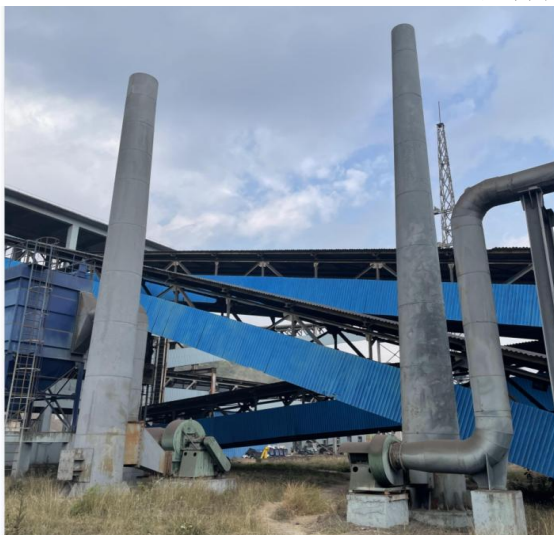
原料场除尘系统
