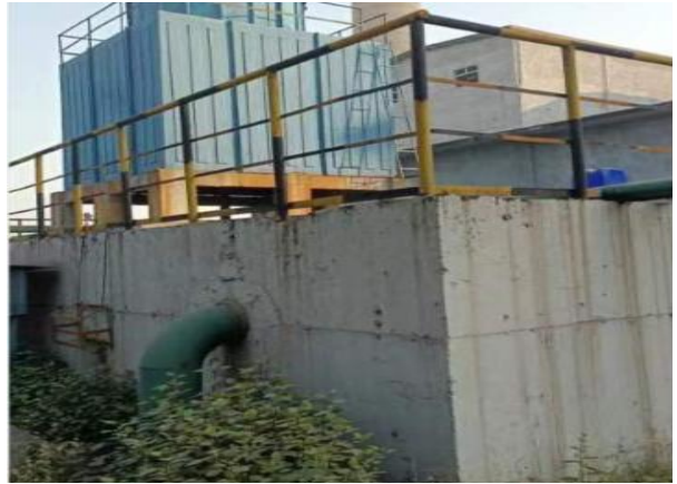
烧结车间循环水池
