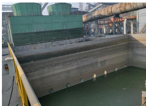
炼铁车间循环水池
