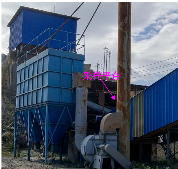
攀千帆二车间中破工序除尘器
