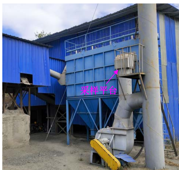
攀千帆一车间筛分工序及磨矿仓除尘器
