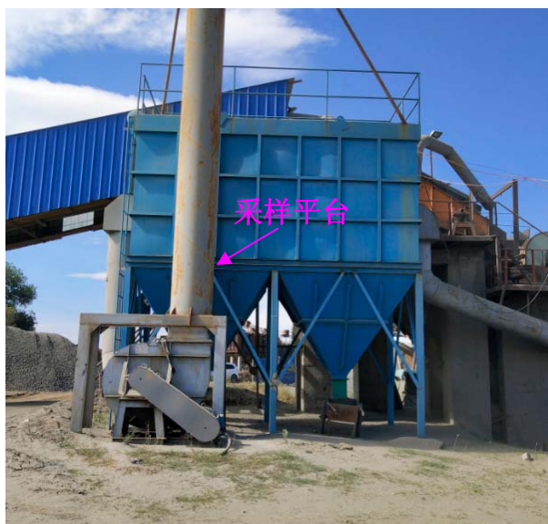
攀千帆二车间细破及筛分工序、磨矿仓除尘器
