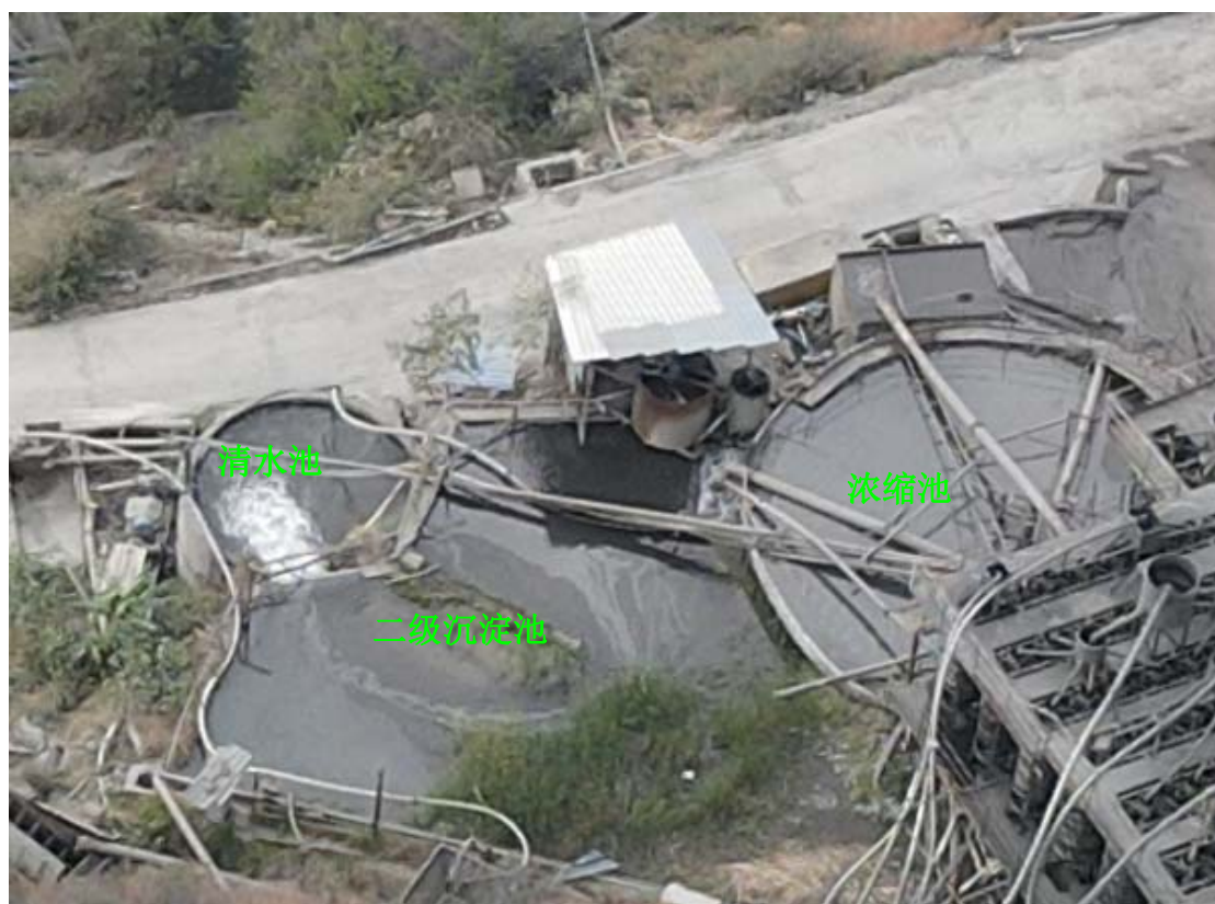
攀千帆二车间洗选废水浓缩系统
