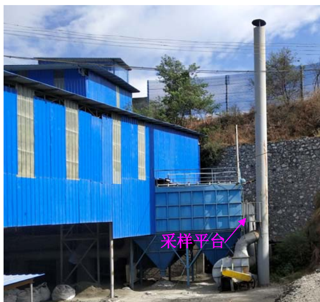
攀千帆一车间中破、细破工序除尘器
