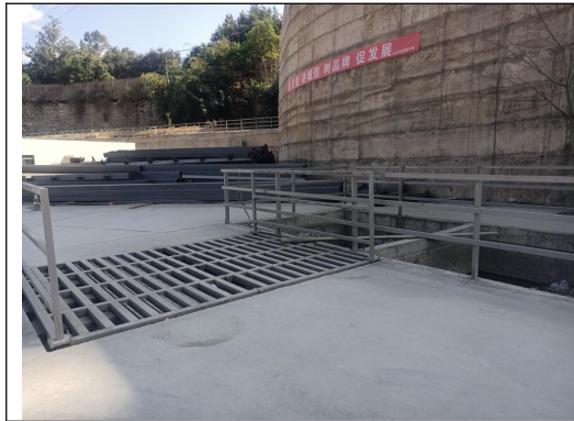
车辆冲洗平台+车辆冲洗废水沉淀池
