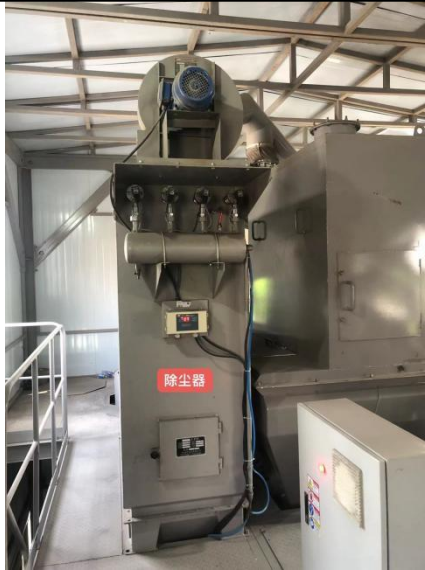
搅拌粉尘处理措施（脉冲式布袋除尘器）
