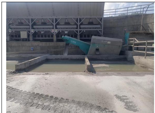
砂石分离机+三级沉淀池
