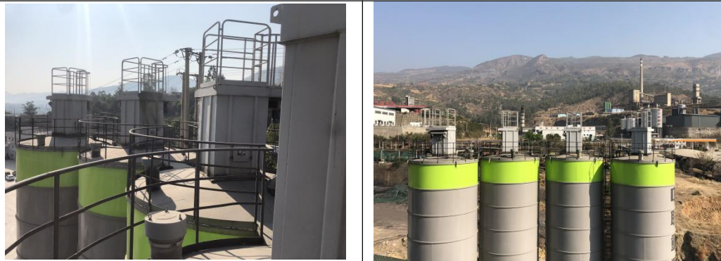
筒仓粉尘治理措施（脉冲式布袋除尘器）
