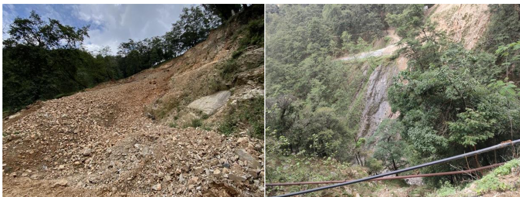
图 9.5-7 项目矿山的泥石流发生地现场照片
