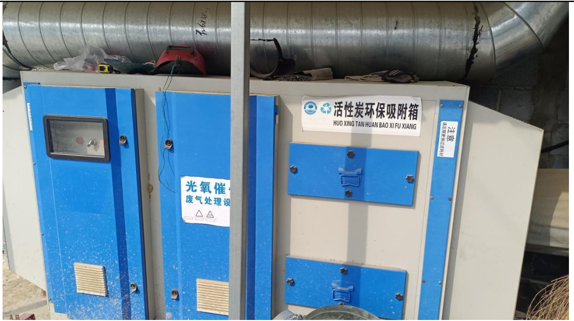
废气处理装置
