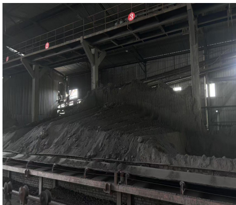
图 2-9 现有陈化库喷洒损坏
