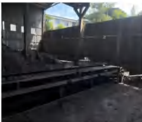
图 2-10 现有车间未全封闭
