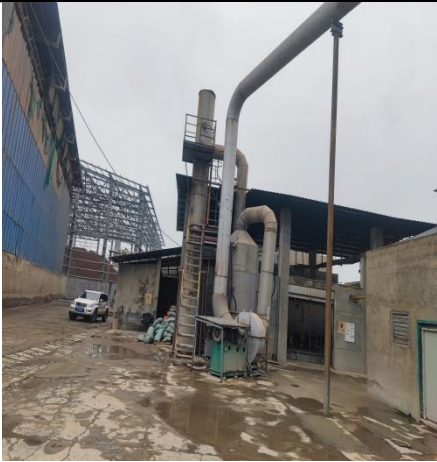
图 2.3-4 蒸汽发生器废气处理设施
