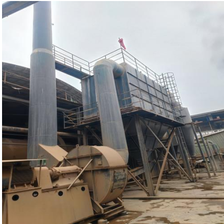
图 2.3-3 原料烘干废气处理设施
