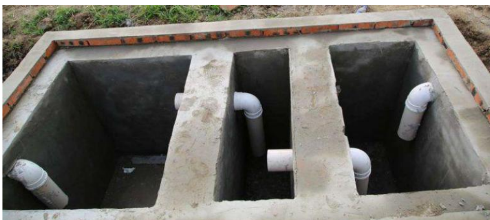
图 4-3 三格砖砌化粪池实拍图
