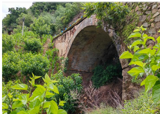
桥梁侧墙胀裂、拱石风化
