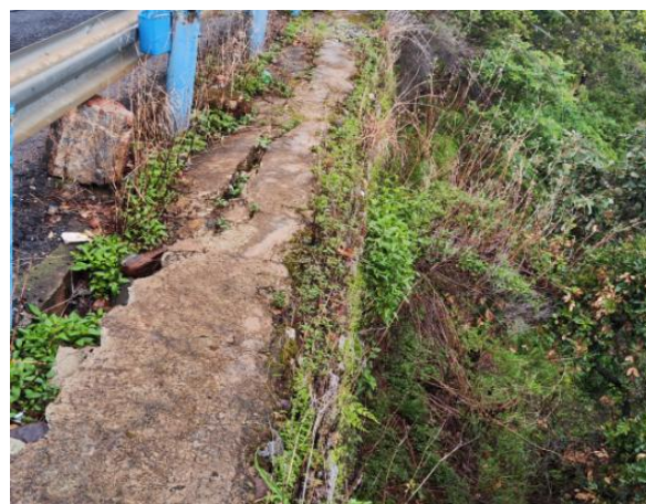
路肩挡墙墙身破坏
